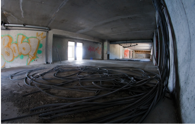
Abb. 47/48: St.Honorè 1500/Isère/F: Menetekel nicht nachhaltiger Erschließung. Die in den 1960er Jahren aus dem Boden gestampfte Skistation mit zwei Seilbahnen und mehreren Liften ist heute eine Geisterstadt. Sie wurde auf Grund wirtschaftlicher Schwierigkeiten 1995 liquidiert. Der Abbau der Lifтанlagen erfolgte 2005–2007.
